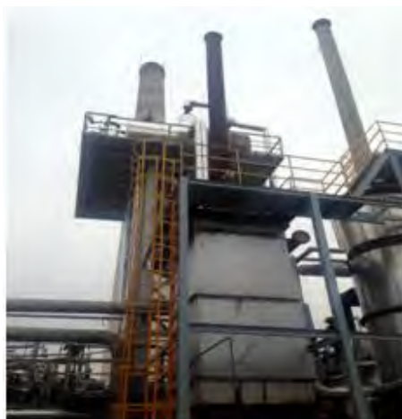
2 套甲醛尾气锅炉
